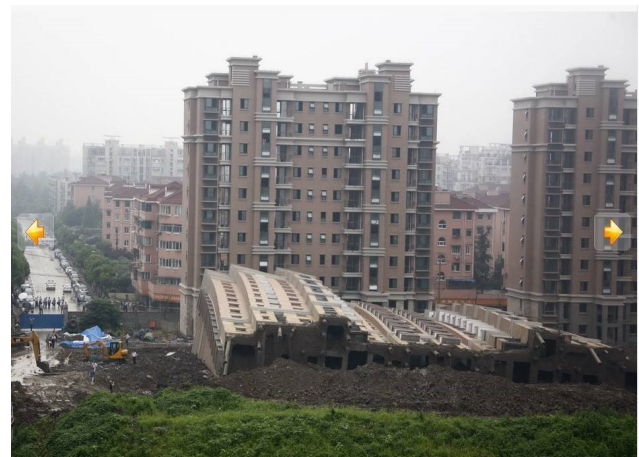
倒塌的大楼 Figures-2a
